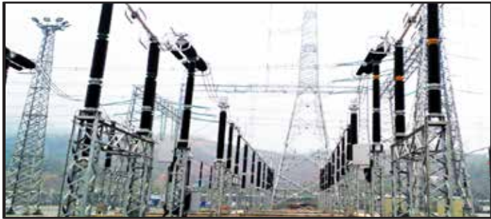
Trạm điện 500KV Thường Tín, 500kV Nho Quan, 500kV Hòa Bình 500KV Thuong Tin, 500kV Nho Quan, 500Kv Hoa Binh Substation
