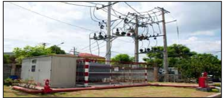
Trạm điện 22kV-35KV Thuộc khu vực Nghệ An, HN, Hà tỉnh 22kV-35kV Substation belong Ha Noi, Nghe An, Ha tinh
