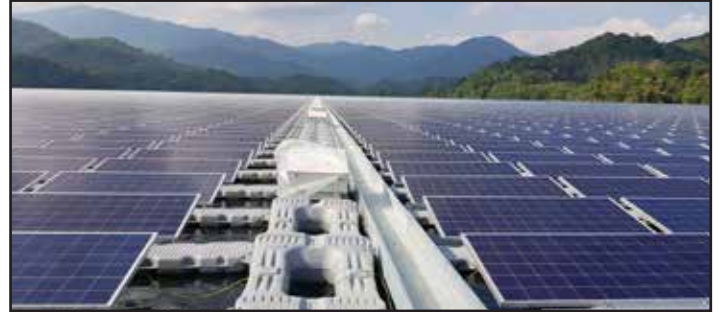
DMT trên Hồ Thủy điện Dami, VSP Bình Thuận, TM2; Tòa nhà EVN, Tòa Nhà Solar Power on Hydro Lake Dami, VSP, EVN Group, EVN HCM Building
