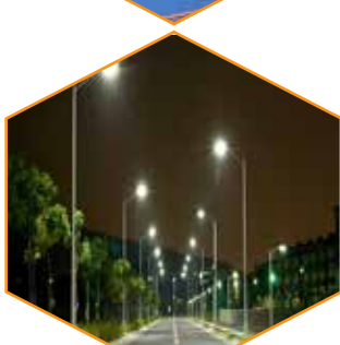
Điện Giao Thông Cầu Cảng Traffic Electricity Wharves
