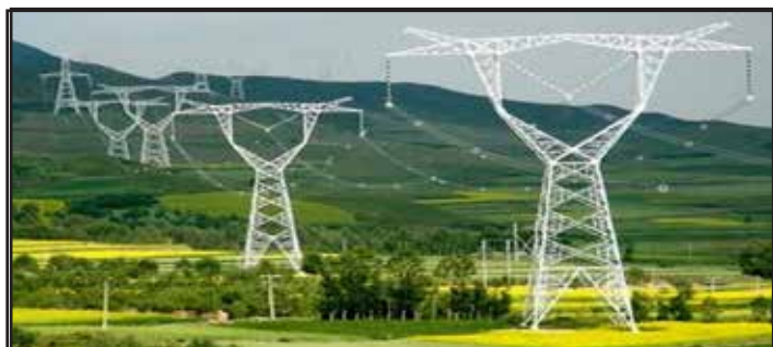
Đường dây truyền tải 500KV Quảng Ninh Transmission line 500KV Quảng Ninh
