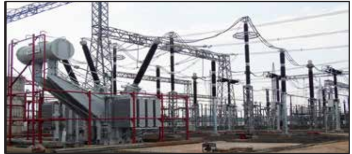
Trạm điện 220KV Hải dương, 220KV Ninh Bình, 220kV Việt Trì 220KV Hai Dương, 220kV Ninh Bình, 220kV Viettri Substation
