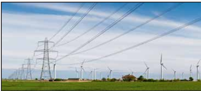
Đường dây 110KV Thuộc EVN-HNPC, EVN-NPC, EVN-SPC 110KV Transmission Line Belong EVN-HNPC, EVN-NPC, EVN-SPC
