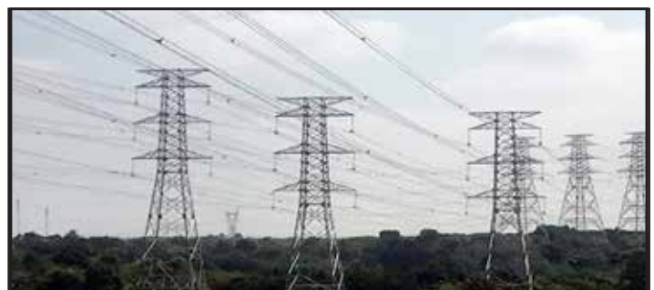
Đường dây truyền tải 220KV Yên Bái, Lào Cai Transmission line 220KV Yen Bai, Lao Cai
