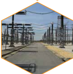
Trạm Biến Áp Substation
