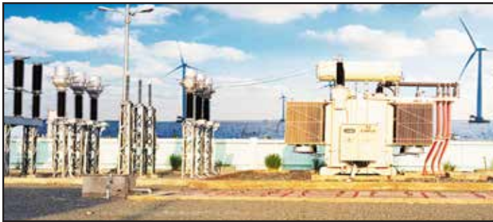
Trạm điện 110KV Thuộc EVN-HNPC, EVN-NPC, EVN-SPC 110KV Belong EVN-HNPC, EVN -NPC, EVN-SPC
